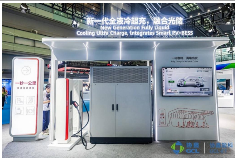
图 600KW 全液冷超充
