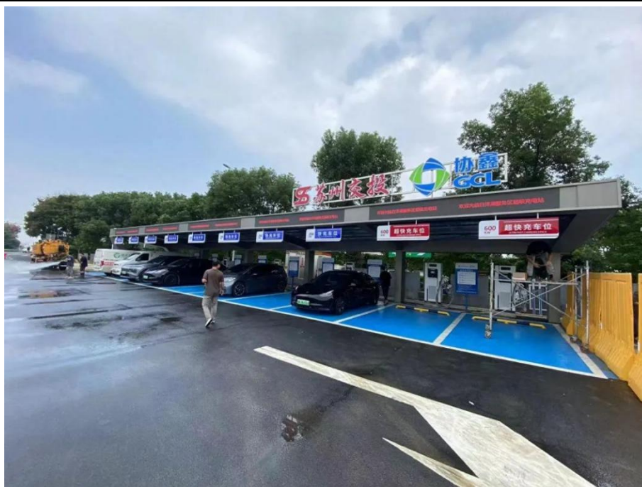
图 江苏高速公路光储充一体化超级充电站
