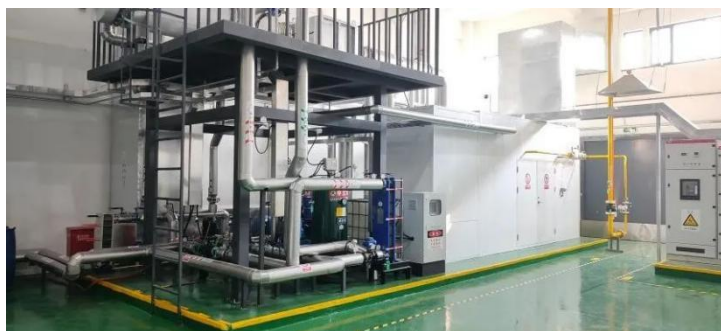
图 常熟第二人民医院碳中和项目
